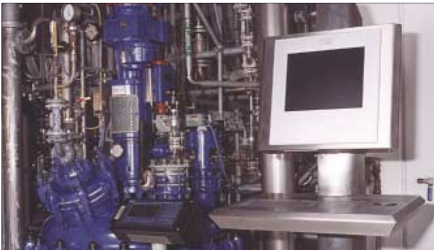
Statt eines Ex-PC ist im Ex-gefährdeten Bereich ein kostengünstiges Bedienterminal eingesetzt
